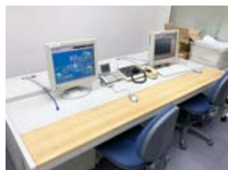
▲現在の中央監視システムPC
