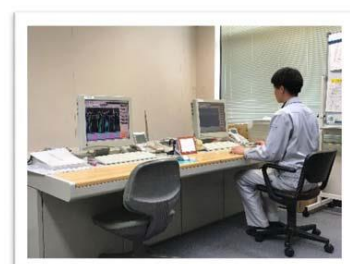
鯉江浄水場内 中央監視装置
