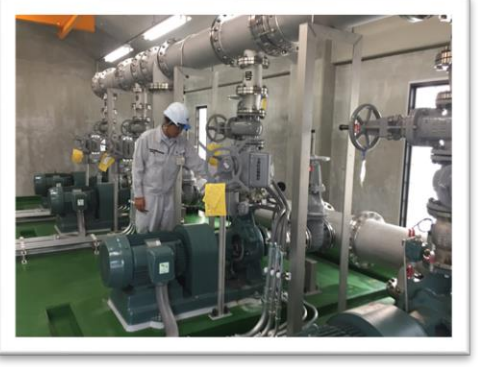
施設点検 (送水ポンプ点検)
