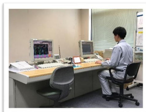
鯉江浄水場内 中央監視装置
