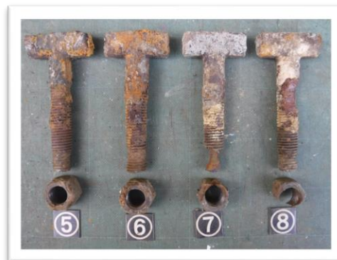
管体調査（ボルト・ナットの腐食状態）
